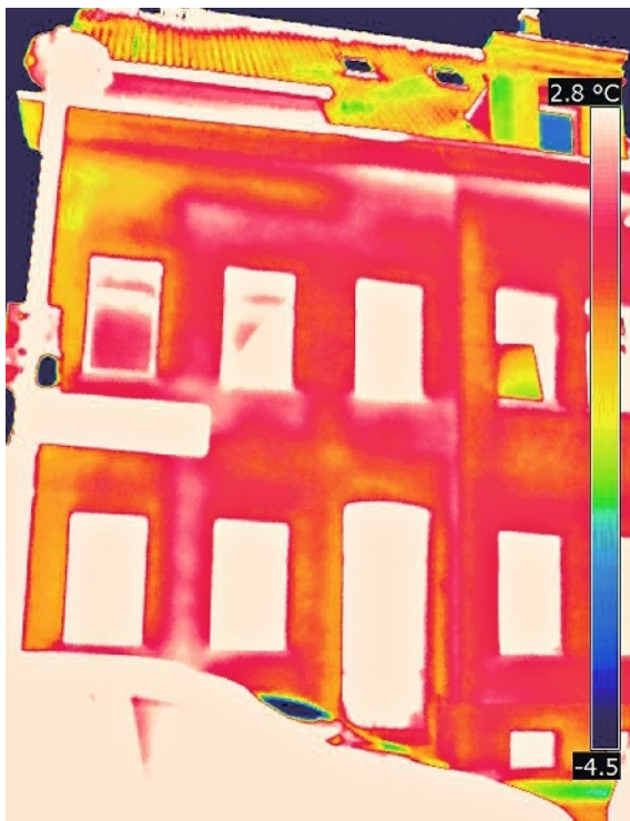
8 Leuchtende Farben: Ein Blick auf das Wärmebild genügt, um die mangelhafte energetische Qualität des Hauses vor der Sanierung zu erkennen.
